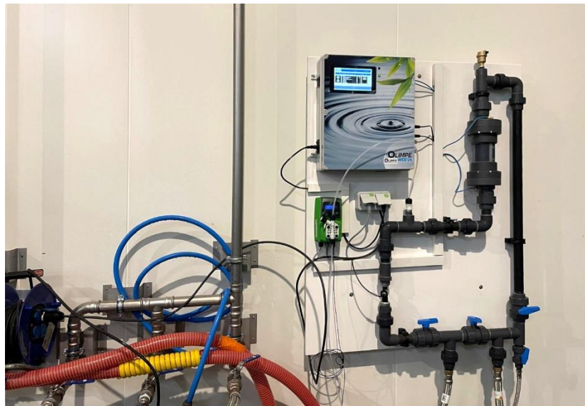
Installée dans l'unité de Production de la Maison Roy, la solution Olimpe permet d'assurer une désinfection RSE, sans produits chimiques
