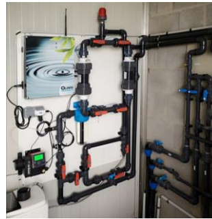
Installation avec 2 cellules jusqu'à 80 m 3 d'eau traitée/jour
