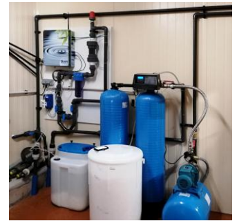
Installation avec 1 cellule + adoucisseur
